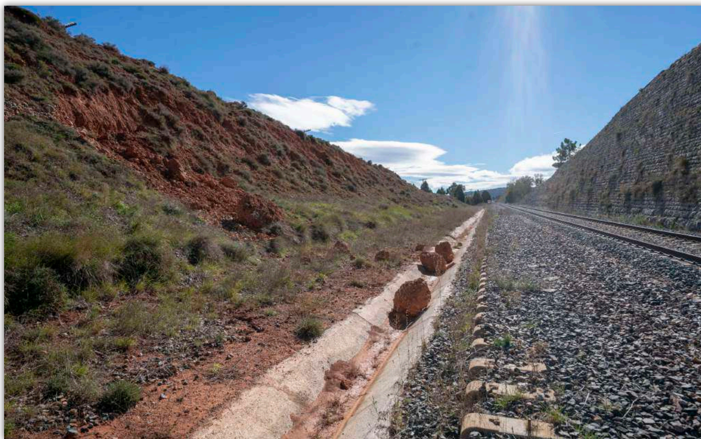
Antonio García-Bykofoto. Desprendimiento de rocas procedentes del talud próximas a la superestructura y afectando al drenaje.
