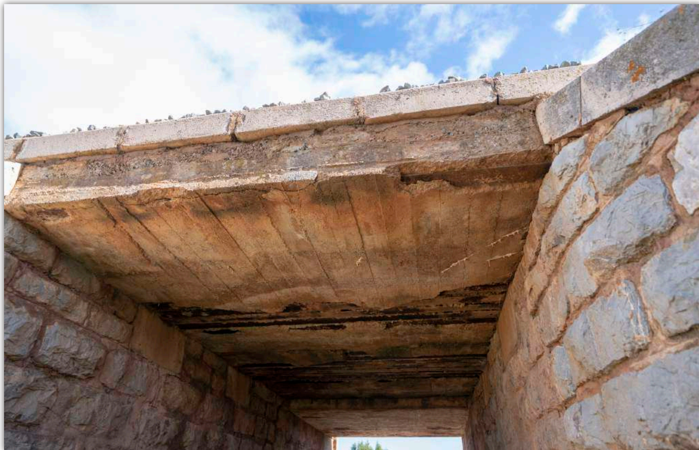
Antonio García-Bykofoto. Pérdida de recubrimiento de la estructura. Oxidación genralizada de los elementos metálicos.
