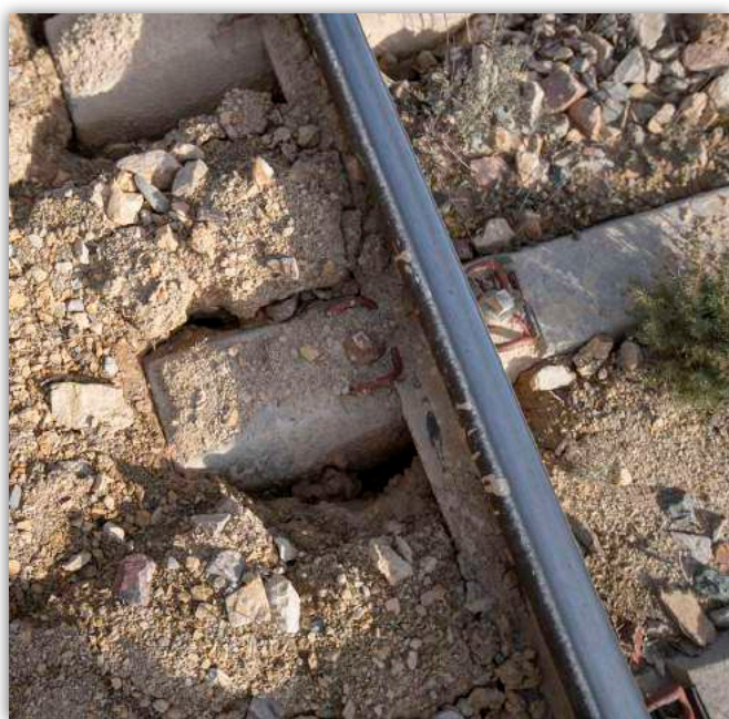
Antonio García-Bykofoto. Traviesa deteriorada.
