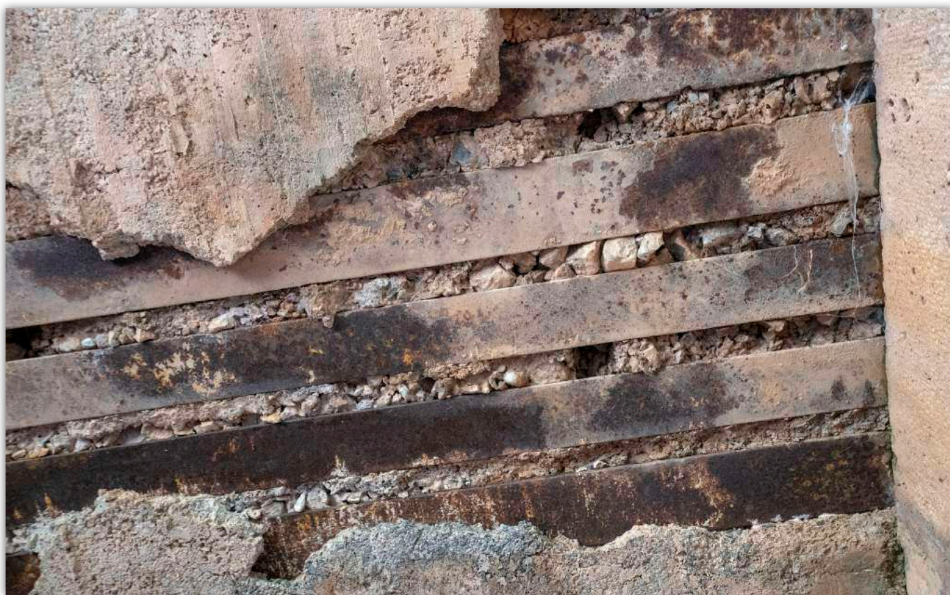
Antonio García-Bykofoto. Pérdida de recubrimiento de elementos metálicos de la estructura con caída de balastro.
