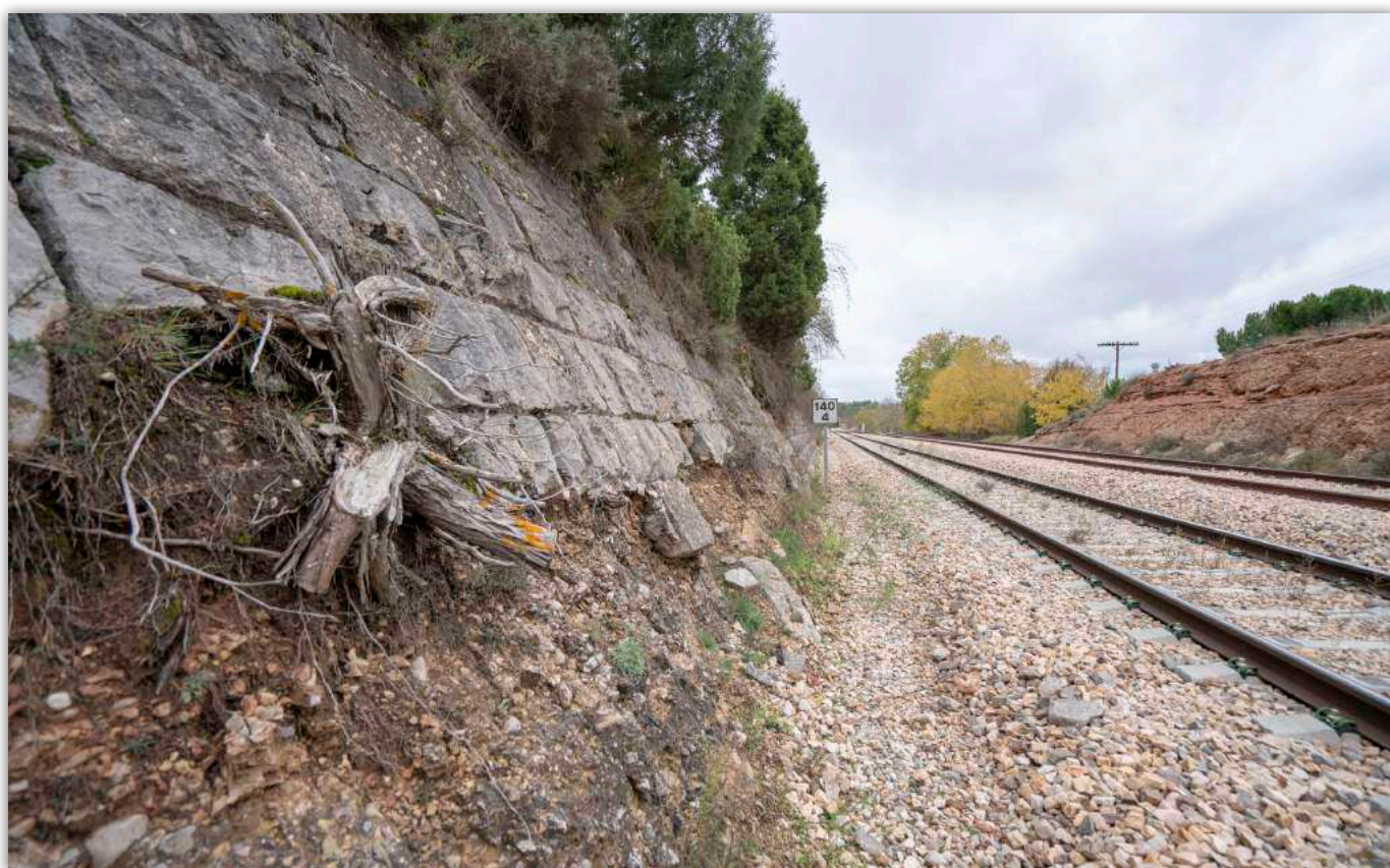
Antonio García-Bykofoto. Pérdida de parte del revestimiento del talud de desmonte. Existencia de vegetación que acelera su deterioro.
