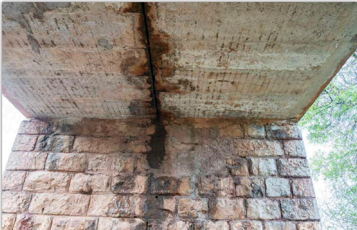
Antonio García-Bykofoto. Armaduras oxidadas y sin revestimiento.
