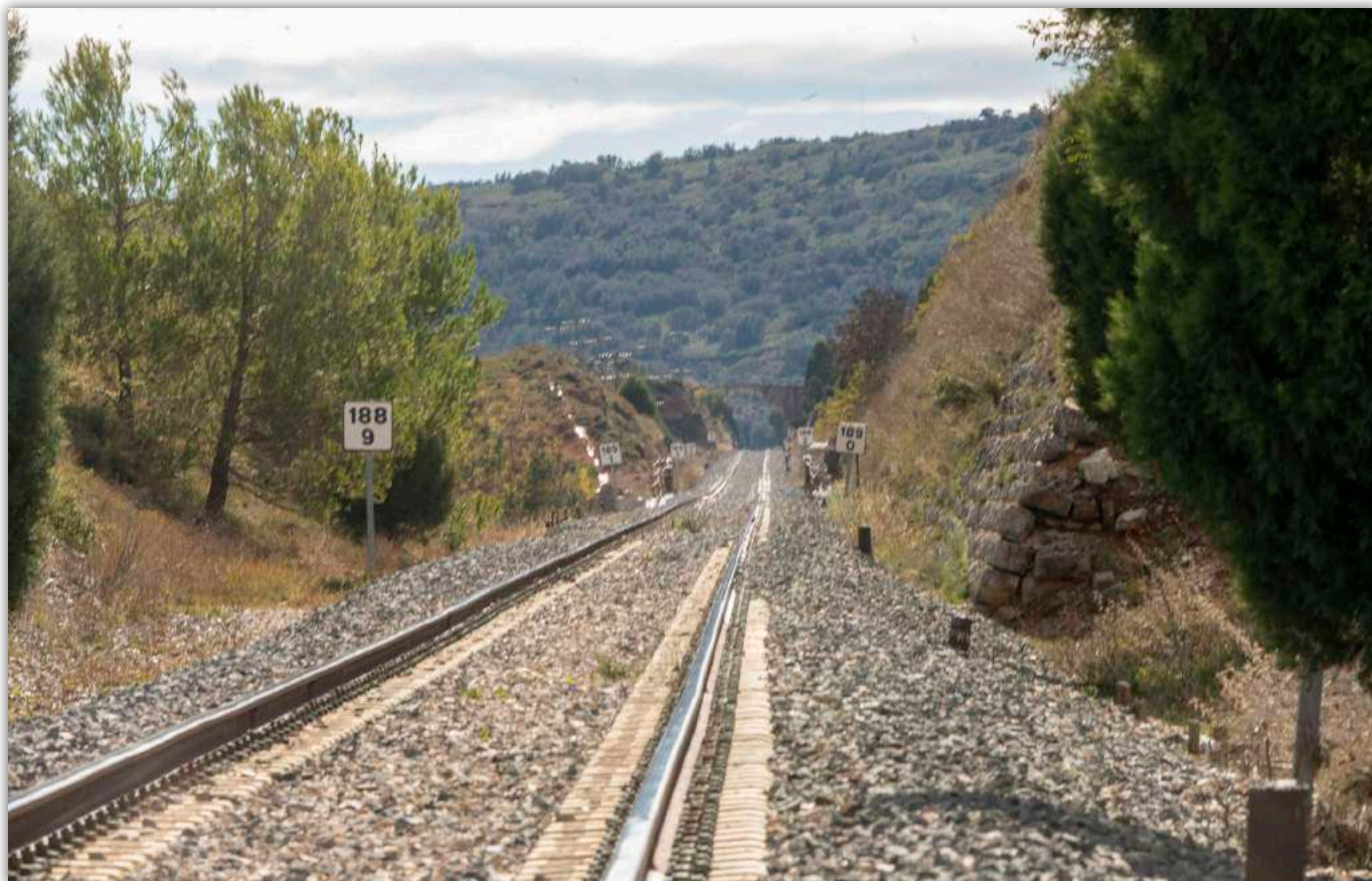
Antonio García-Bykofoto. Superestructura con carriles mal perfilados.
