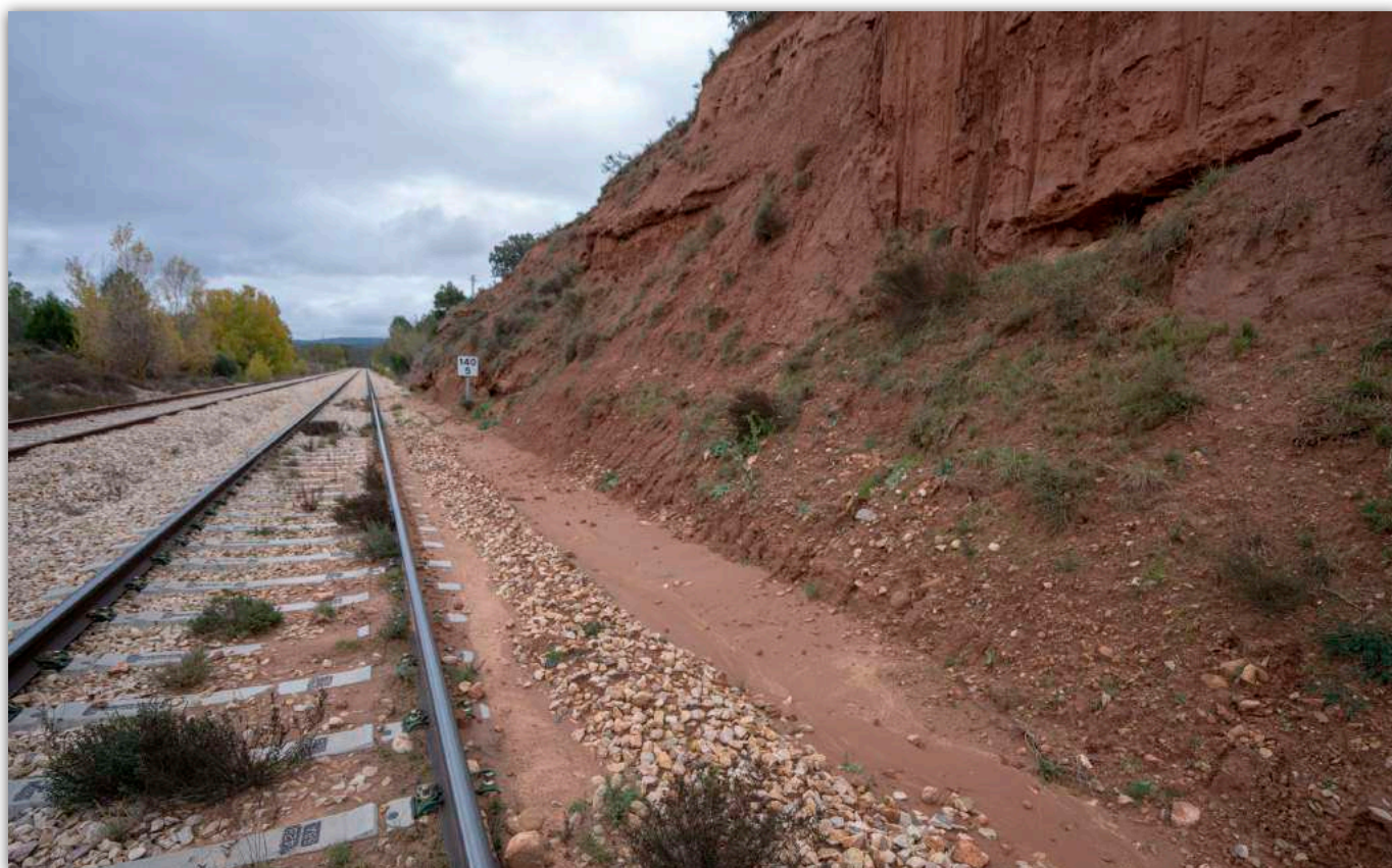
Antonio García-Bykofoto. Cuneta de drenaje colmatada y superestructura afectada por arrastres de tierra y barro, con vegetación.
