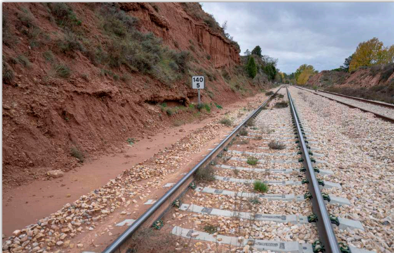
Antonio García-Bykofoto. Balastro contaminado con tierra y barro.
