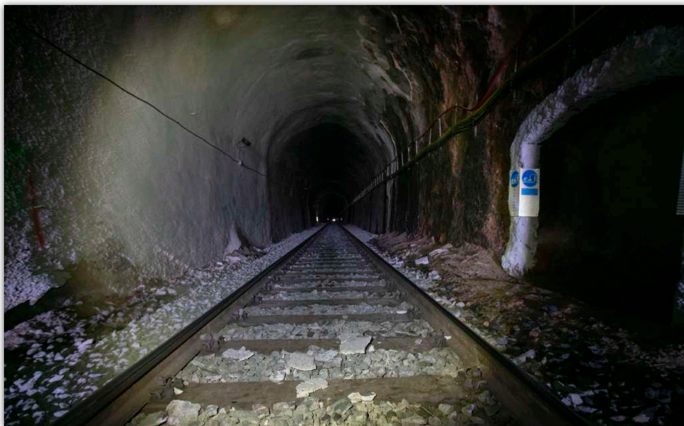
Antonio García-Bykofoto. Desprendimiento de material de la bóveda y del recubrimiento del hastial del túnel que afecta a la superestructura.
